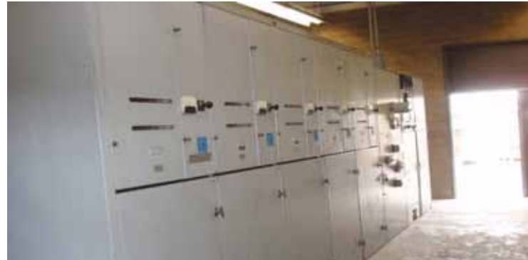
Main 5KV Switchgear
